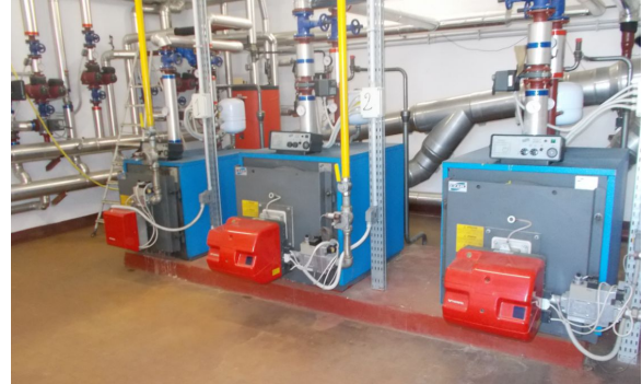
Figura 7.4 – Particolare della caldaia
