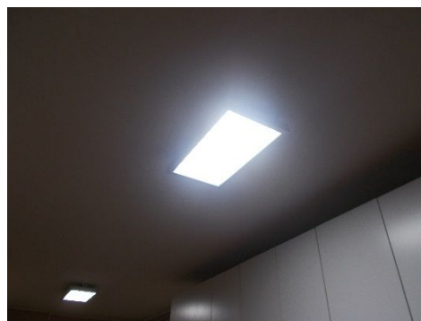
Figura 3.15 - Particolare dei corpi illuminanti
