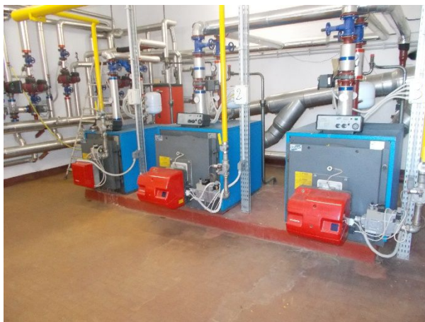
Figura 3.12 - Particolare dei generatori
