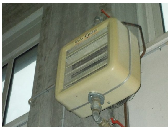
Figura 3.7 – Particolare degli aerotermi
